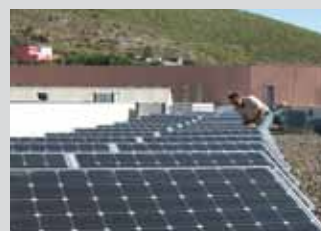
Deutsche Schule, Teneriffa, 88kWp
